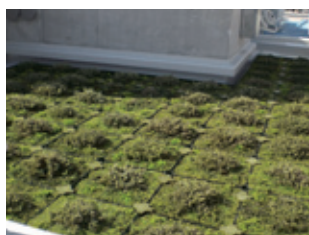
屋上緑化「プリオセダム」
