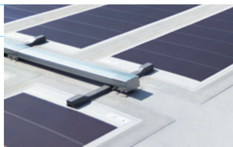
ケーブルラック終端部
