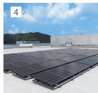
4 電気設備工事業者により、専用架台と太陽光設備設置工事を行い完成。
