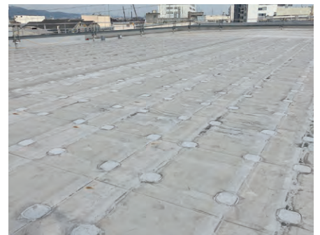
撤去した太陽光設備基礎部はパッチで補修。 防水改修完了までの雨養生に配慮。
