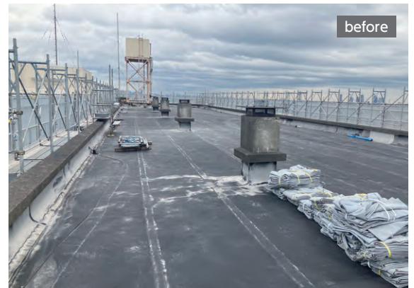
既存ゴムシート防水は経年による劣化が見られました。
