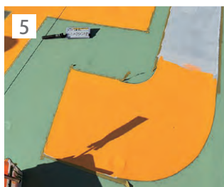
5 文字に合わせてルミノヘリサイン(下塗り)を塗布し、2時間乾燥させる。
