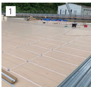
1 耐火デッキプレート工事後、FLボードNUを敷設し、IH断熱ディスクを設置・固定。
